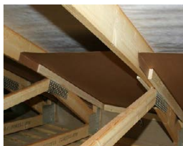
Установленная направляющая потока воздуха ISOVER
